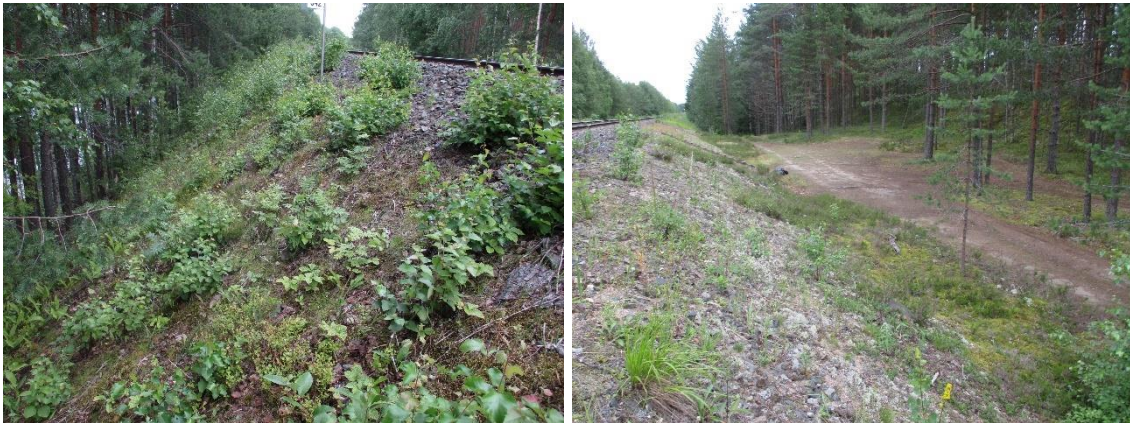
Kuvat 8 ja 9. Radan pohjoistörmää ja etelätörmää Matkalammen eteläpuolella (kohde 3).
